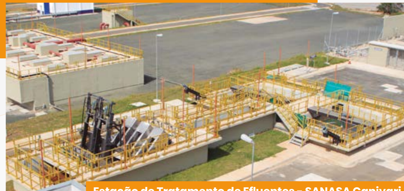
Estação de Tratamento de Efluentes – SANASA Capivari I
